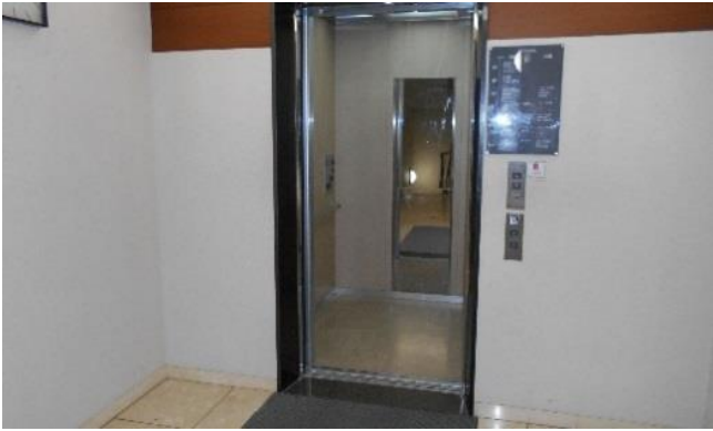
本館エレベーター
