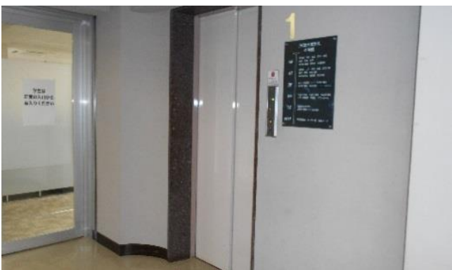
4号館エレベーター
